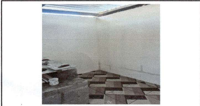
Foto 15: 21.2 Cernido en muro de la cocina escolar
